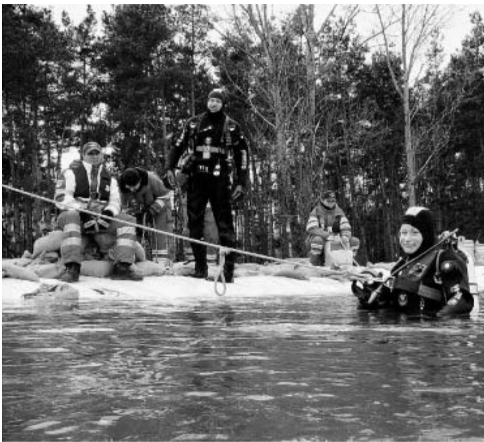
Taucher deckten den Deich unter Wasser mit Planen ab. Die Schutzfolie saugte sich an der Oberfläche fest und verhinderte ein weiteres Aufweichen.
